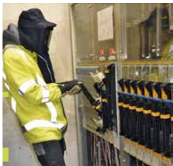
Beim Einschalten des Stroms nach der Montage der Klappwandler ist Vorsicht geboten.
